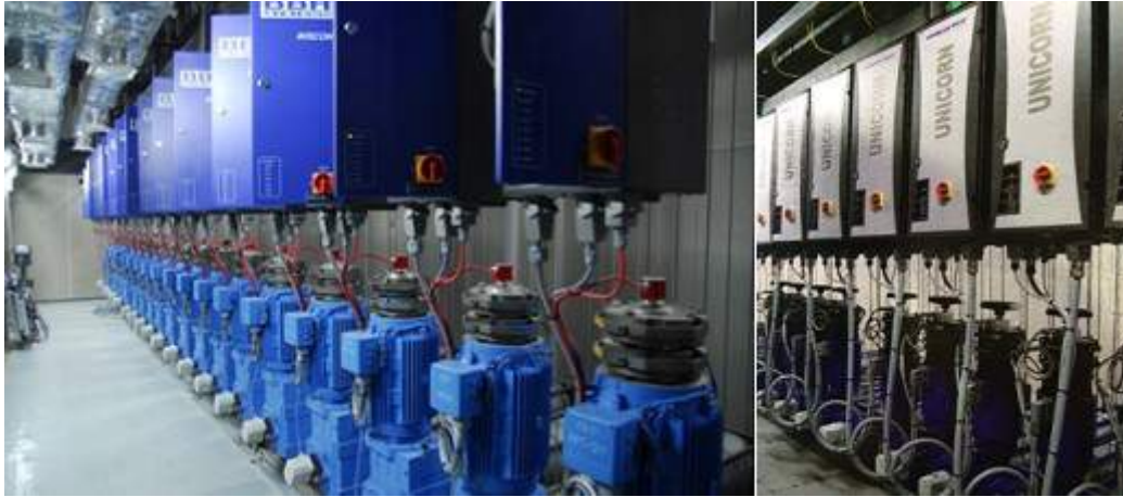
그림 1-26 구동부실 1 : 1 Control Panel
