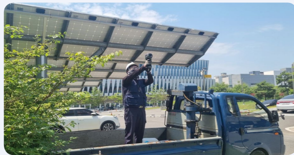
나주청사 태양광발전설비 안전점검
